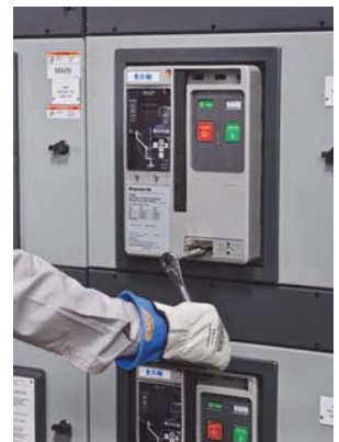
Levering Magnum DS Breaker
